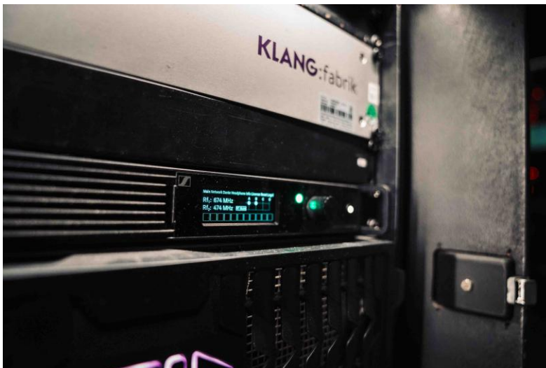
Schnell einsatzbereit: die Spectera Base Station im kompakten 19", 1-U-Format (Bildmitte)
