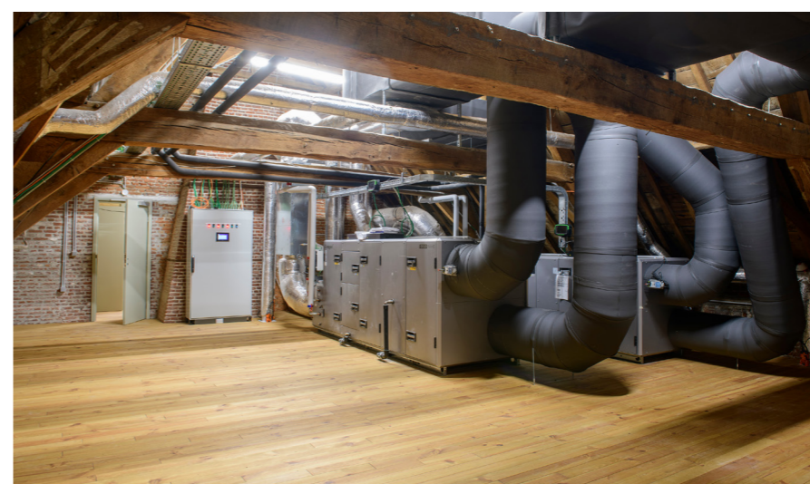
Technische installatie op zolder, © Jo Exelmans
