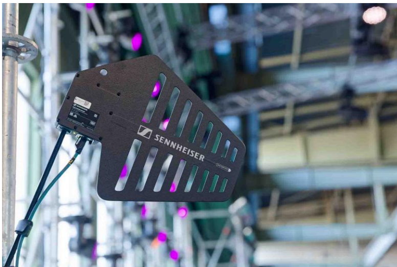
Acht Spectera DAD-Antennen waren im Hangar 4 angebracht
