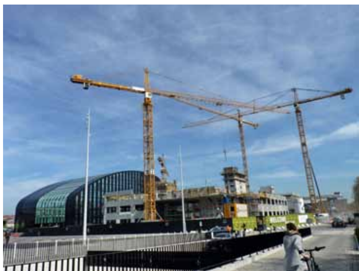
Bruxelles Environnement et le chantier de l'Herman Teirlinck, avenue du Port Leefmilieu Brussel en de werf van het Herman Teirlinckgebouw, Havenlaan Bruxelles Environnement and the Herman Teirlinck building site, Avenue du Port
