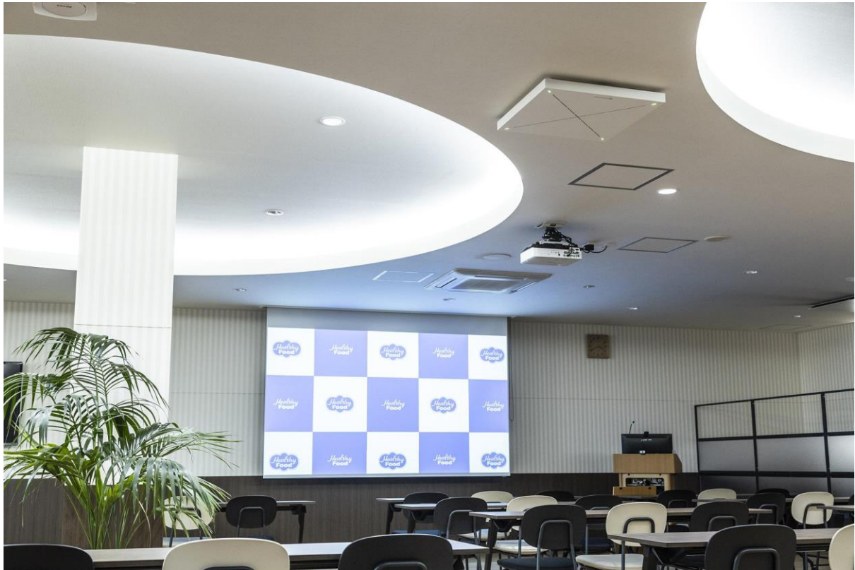
全体をカバーするように天井に2台のTCC 2が設置されている
