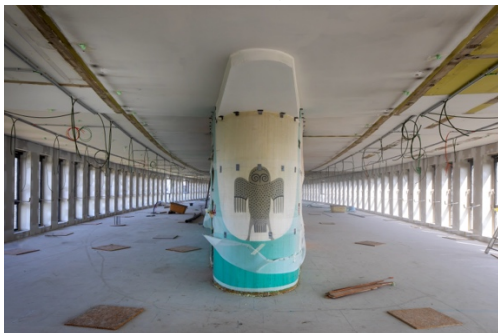
Beeld van tijdens de werkzaamheden met beschermfolie voor muurschilderingen (H. Hermans, mei 2023)
